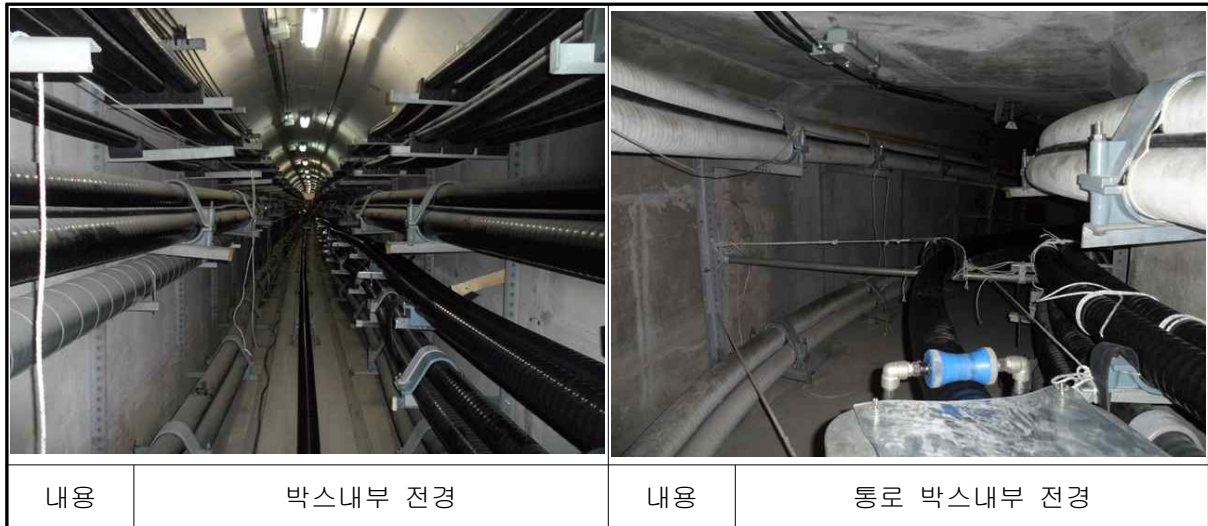
【사진 1.1】 구리인출 전력구 현황
