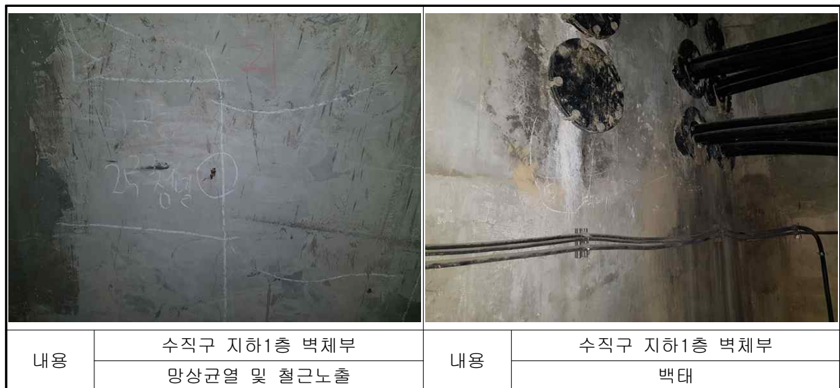
【사진 1.3】 구리인출 전력구 수직구 손상현황
